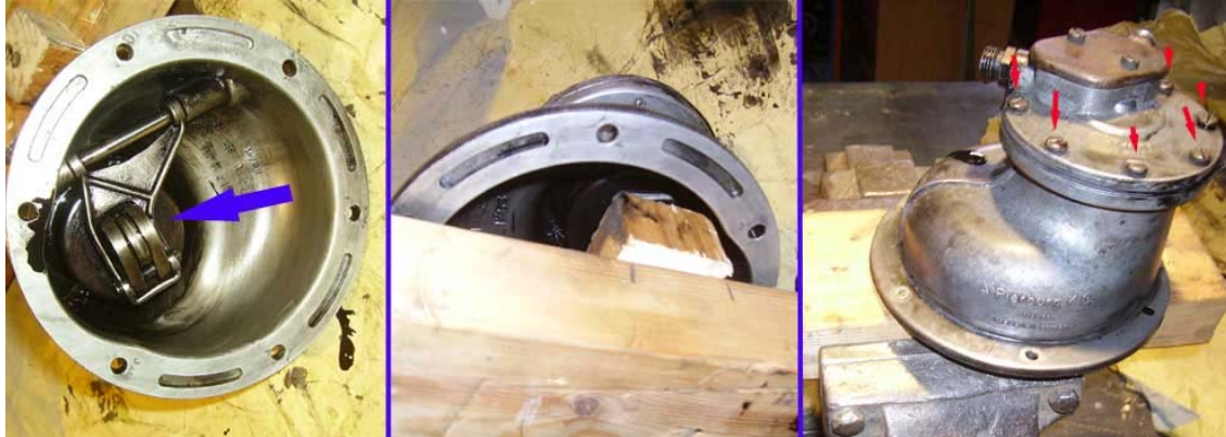
Bild: Links der blaue Pfeil zeigt den Kolben, der 12.5 mm hochgedrückt werden soll. Rechts die roten Pfeile zeigen die Verschraubung des runden Deckels, unter dem die Membran sitzt.
